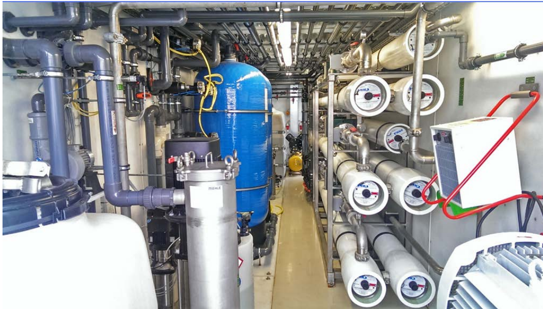
Рис. 5 - Внешний вид контейнерной Установки обратного осмоса по очистке фильтрата полигона
